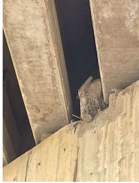
d) Kule yapısı makine teçhisat hasarı
