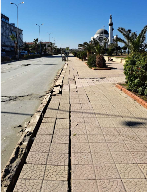
a) İskenderun'da sıvılaşmadan dolayı yolda ve yaya kaldırımında meydana gelen hasarlar
