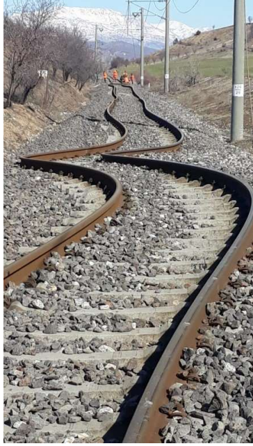
a) Gölbaşı-Malatya demiryolu hattı yer deformasyonu
