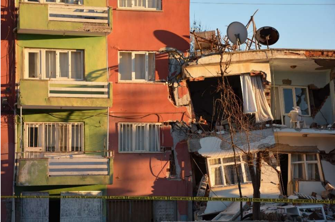
Şekil 4.10 : Bitişik nizamda teşkil edilen yapılarda gözlenen ‘Çekiçleme Etkisi’
