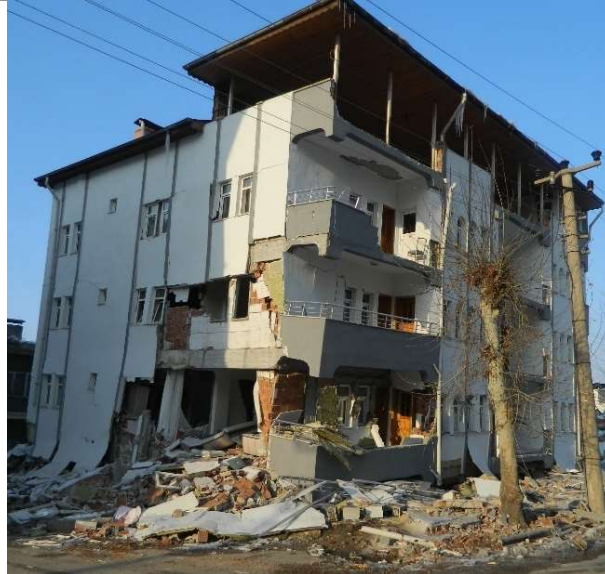
Şekil 4.6 : Kısmen yıkılmış olan binalar-devamı
