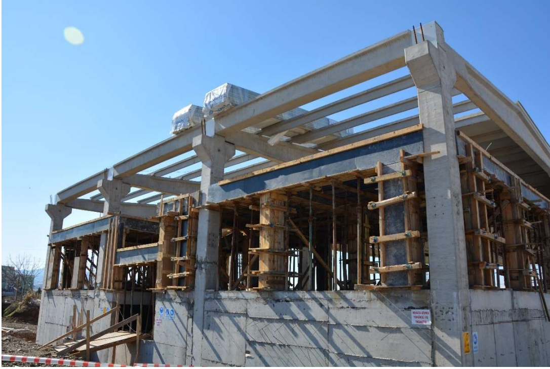
Şekil 4.13 : Kahramanmaraş'ta bir tekstil işletmesinde yeni yapılan bir inşaatta görülen yapısal hasarlar ( kolon donatılarında burkulma )
