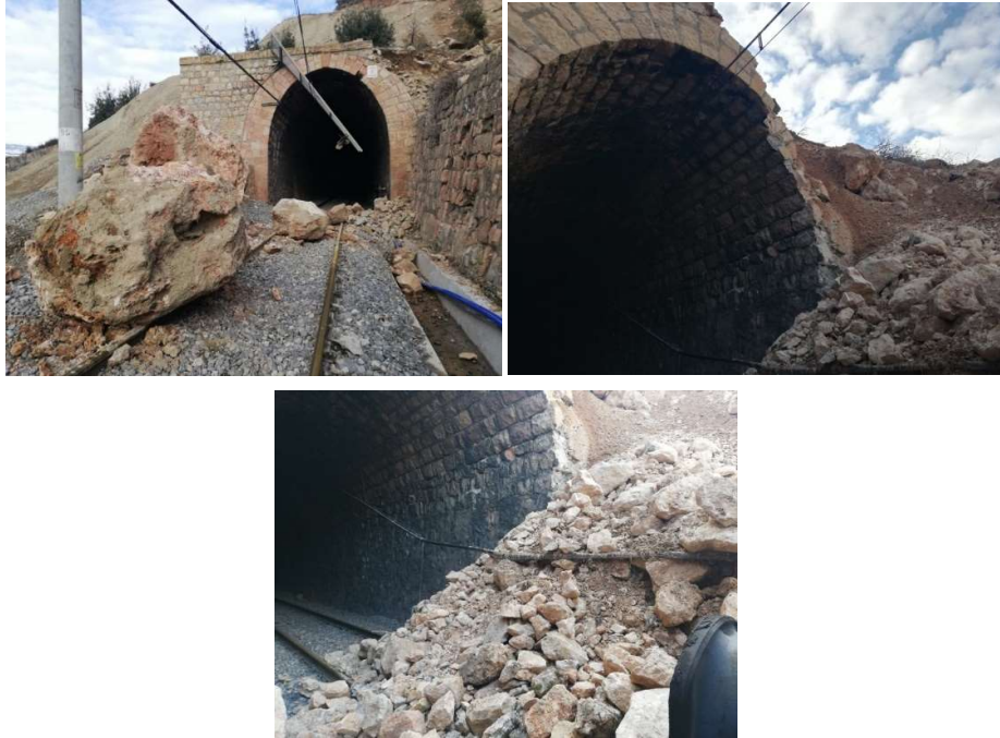
c) Demiryolu hattı tünel girişinde kaya düşmesi ve toprak kayması nedeni ile tünel girişinin kapanması ve tünel yapısı hasarı
