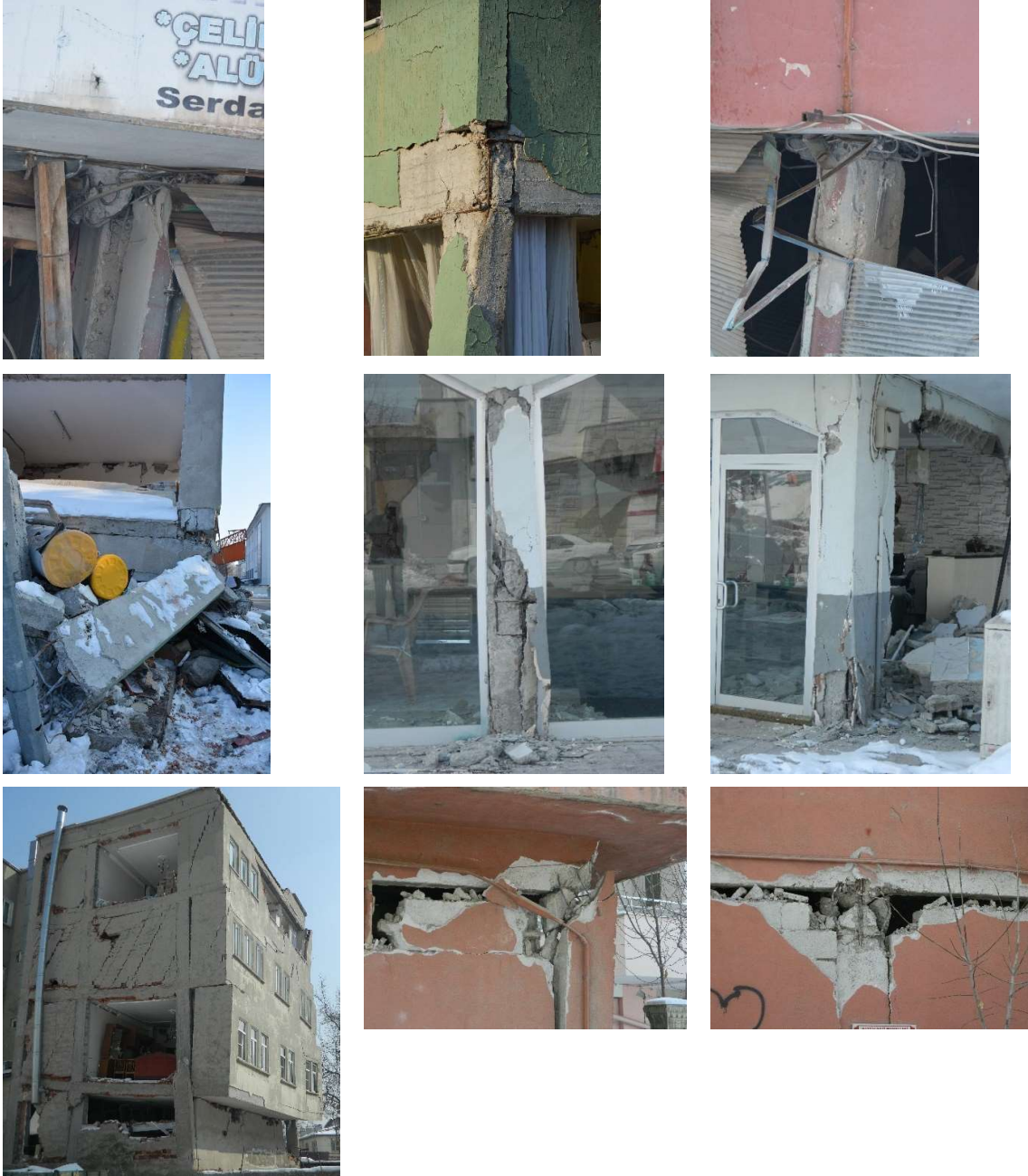
Şekil 4.2 : Yetersiz birleşim detaylarında gözlemlenen problemler
