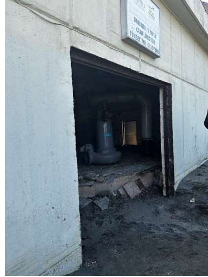
Şekil 5.2 : İskenderun'da kanalizasyon ve yağmur suyu yükseltme istasyonunda sızılaşma sonucu oluşan hasarlar
