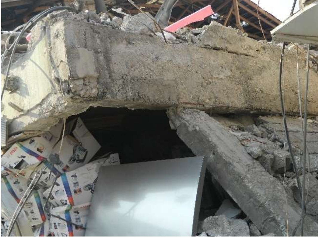
Şekil 4.3 : Güçlü kiriş-zayıf kolon olarak gözlenen tasarım problemi
