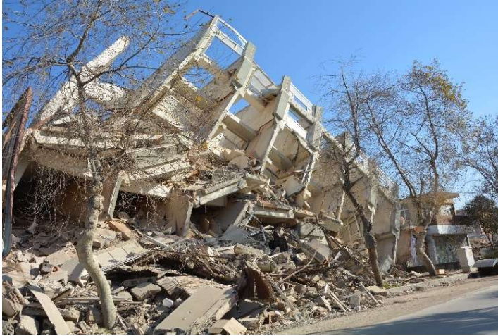
Şekil 4.7 : Tamamen yıkılmış olan binalar
