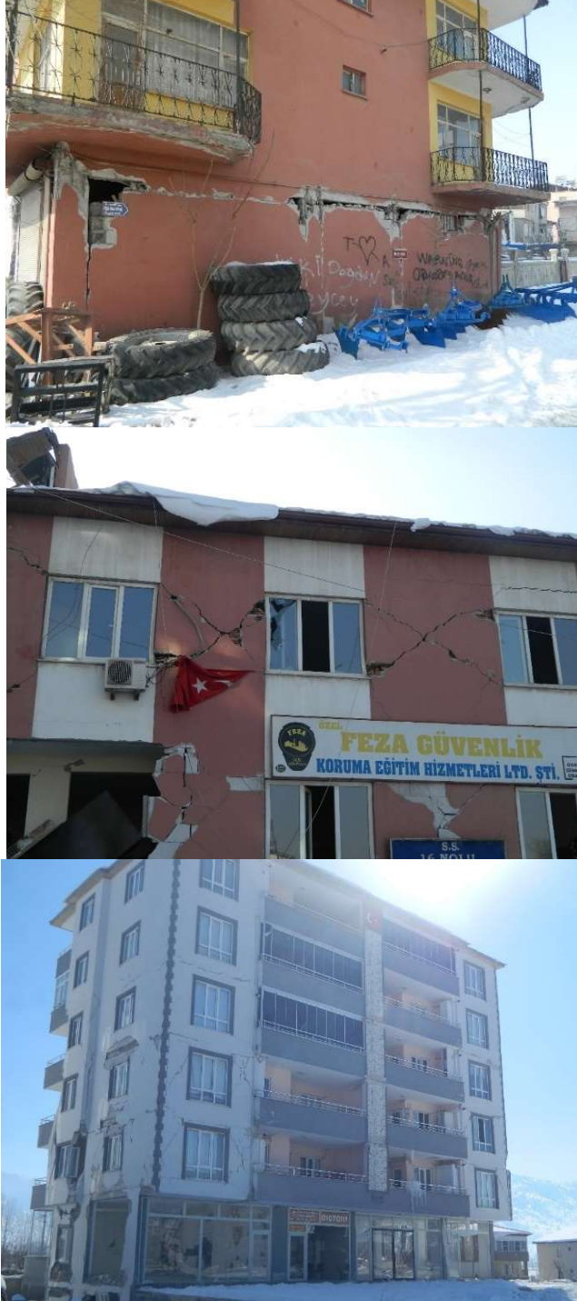
Şekil 4.8 : Dolgu duvar hasarlarından örnekler
