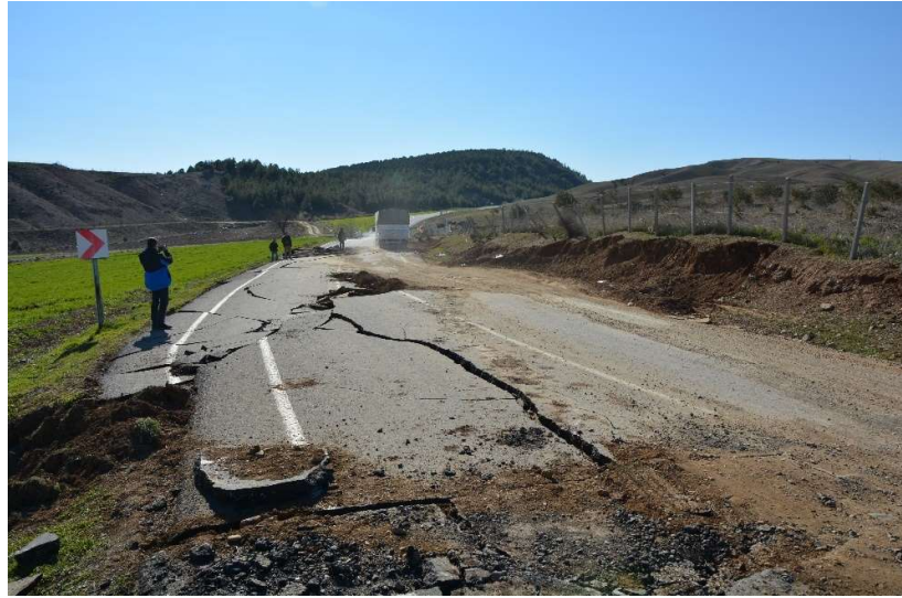
Şekil 5.10 : Pazarcık – Tevekkeli köy yolu ve fay kesişim noktasında hasar gözlemleri
