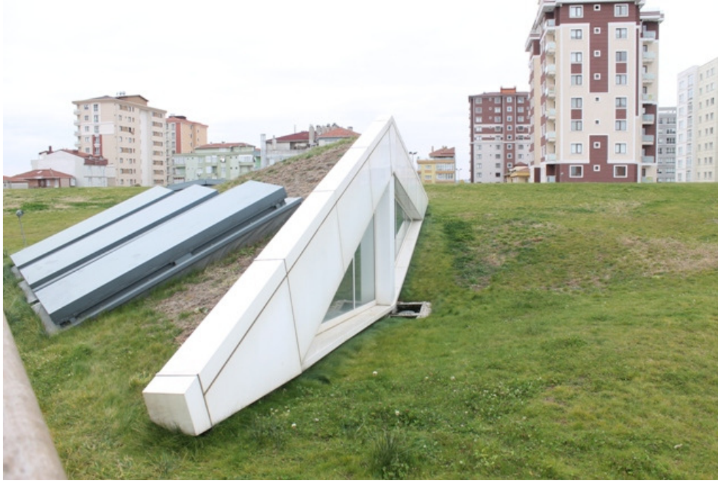
Resim 5: Yapının gezilebilir yeşil çatıları üzerindeki doğal aydınlatma yarıkları ve havalandırma kapaklarına ait detaylar
